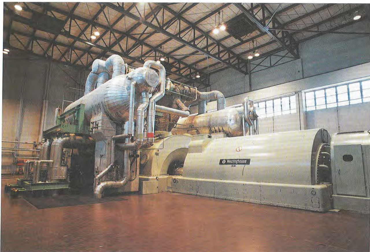
Sala de turbinas de la central José Cabrera
